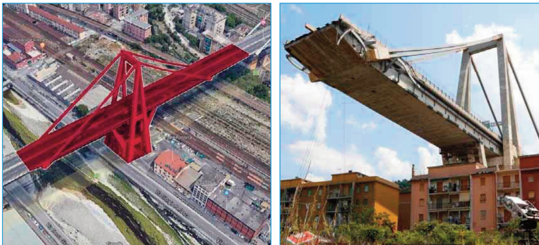
Figure. 5 e 6 - Porzione rossa crollata e parte rimanente lato pila 10
